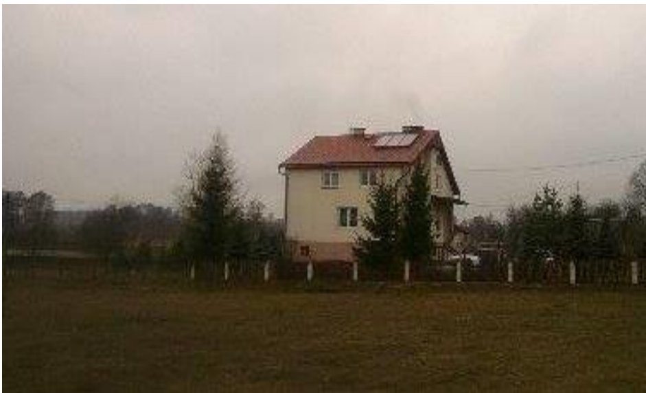
Rysunek 6. Kolektory słoneczne płaskie na dachu budynku jednorodzinnego w Butrymowcach
