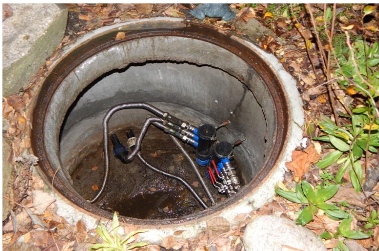
Rysunek 9. Studzienka rozdzielaczowa dolnego źródła ciepła dla pompy ciepła w Narwi
