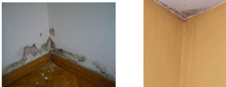
Rys. 3. Jednoczesne występowanie wilgoci kapilarnej i kondensacyjnej
