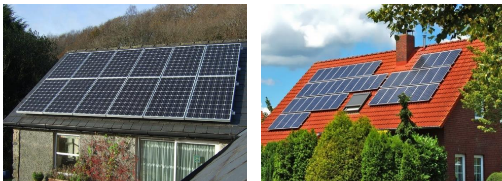
Rys. 3. Instalacje fotowoltaiczne zainstalowane na dachach gospodarstw domowych
