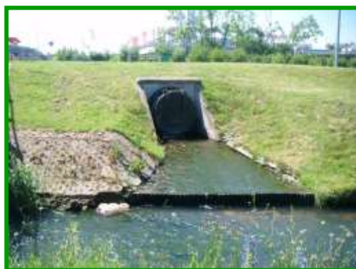
Rysunek 8. Miejsce poboru próby - wylot z separatora typu Huaraton SKG2B250
