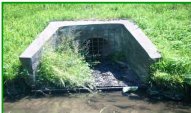
Rysunek 5. Miejsce poboru próby - wylot z separatora typu Dywidag 150
