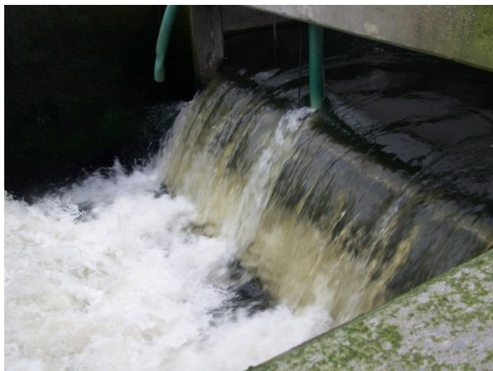
Rysunek 5. Wypływ ścieków oczyszczonych do rzeki Drwiny – tuż za stacją pomiarową.
