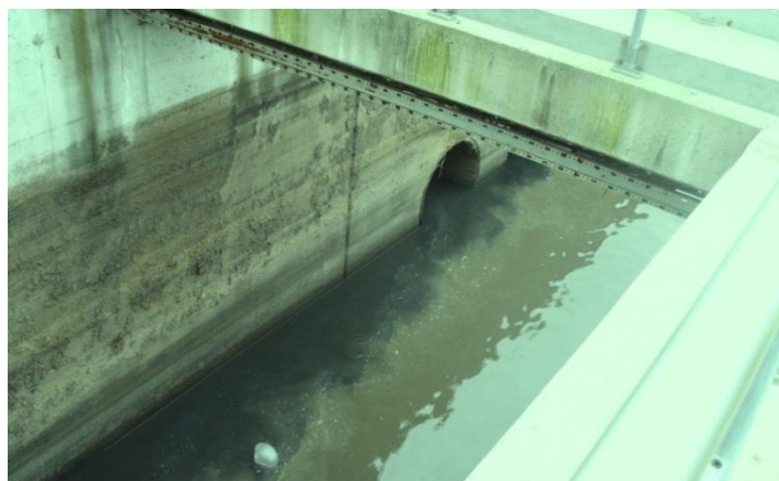
Rysunek 4. Dopływ ścieków do oczyszczalni, tuż przed kratami rzadkimi.
