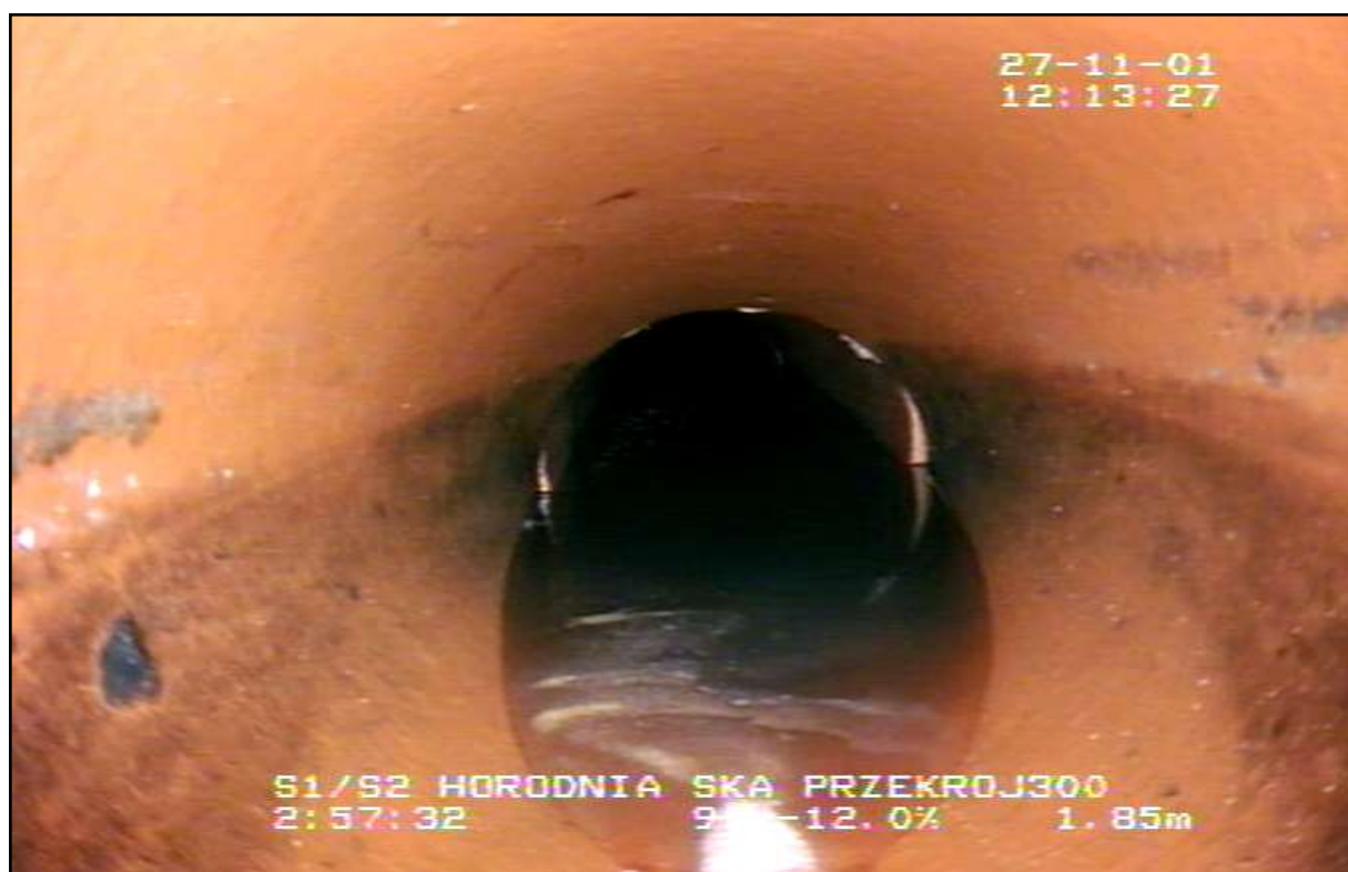
Rys. 5. Brak zachowania spadku na kanale kamionkowym tzw. „syfon”. [3]
