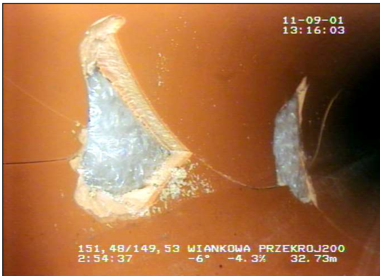
Rys. 7. Uszkodzona kanalizacja podczas budowy wykonana z rur PVC.[3]
