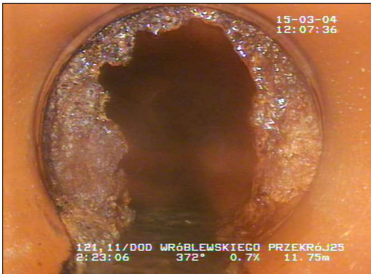
Rys. 9. Wytworzenie się nacieku przez nieprawidłowe uszczelnienie.[3]
