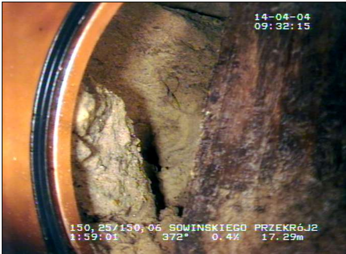
Rys. 11. Brak korka zamykającego trójnik PVC.[3]
