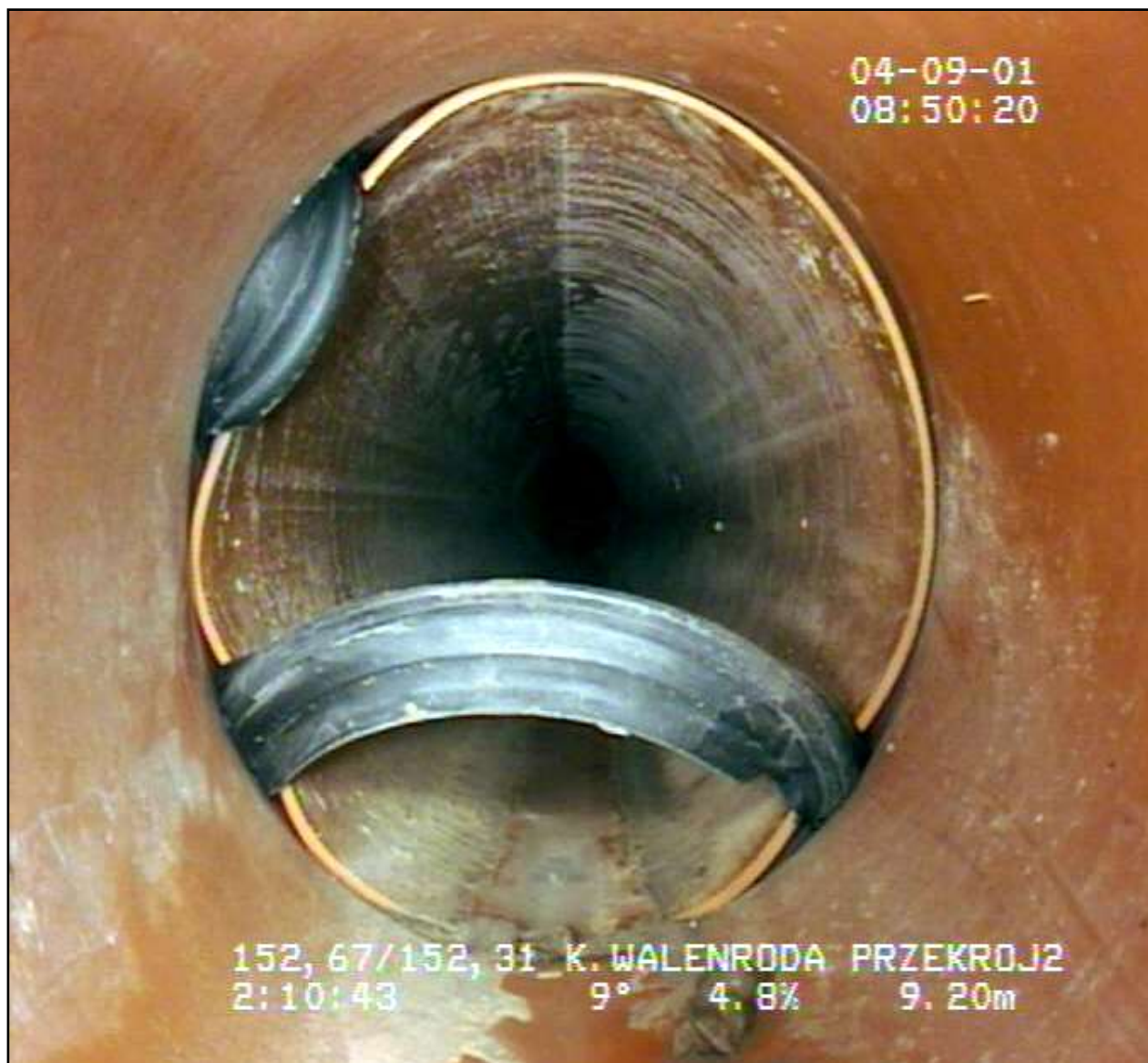
Rys. 6. Wypchnięta uszczelka w kanalizacji wykonanej z rur PVC.[3]
