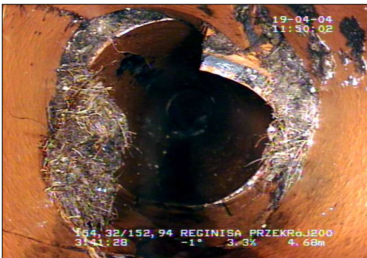
Rys. 19. Uszkodzenie kanalizacji przez rosnące korzenie [3]
