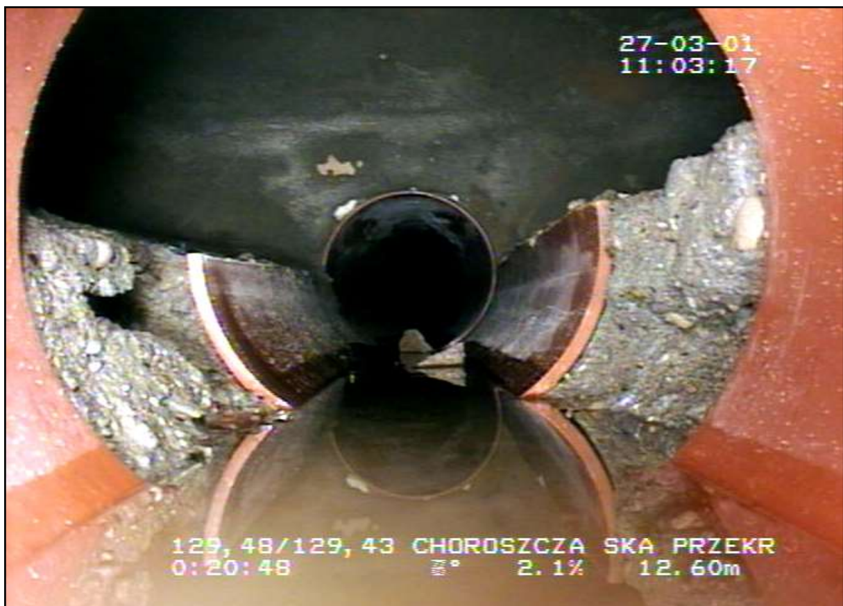
Rys. 12. Źle wykonane dno studni, rozmyta kineta.[3]
