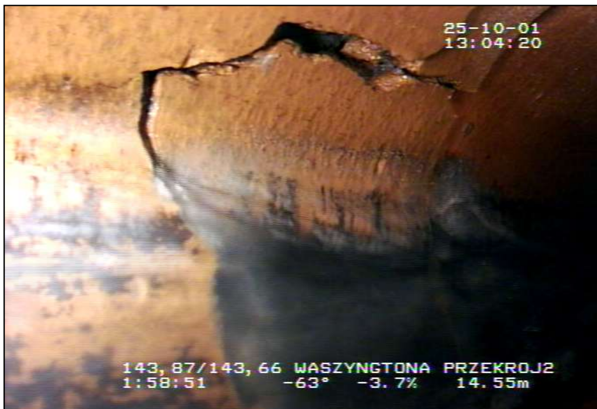
Rys. 1. „Przyszłe miejsce awarii” na kanale sanitarnym, wykonanym z rur kamionkowych.[3]
