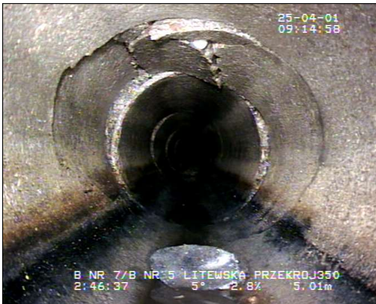
Rys. 2. „Początek awarii” na kanale deszczowym wykonanym z rur betonowych.[3]
