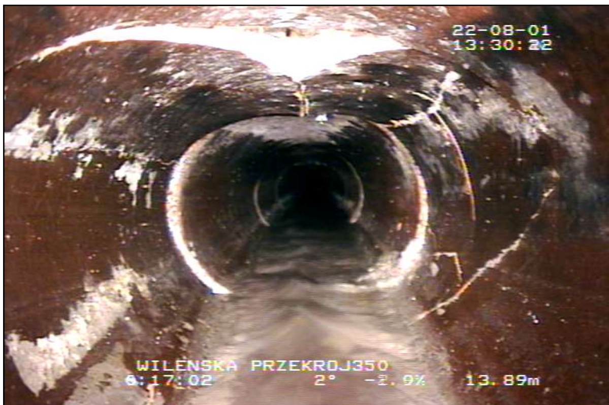
Rys. 18. Tzw. składanie się kanału kamionkowego [5]
