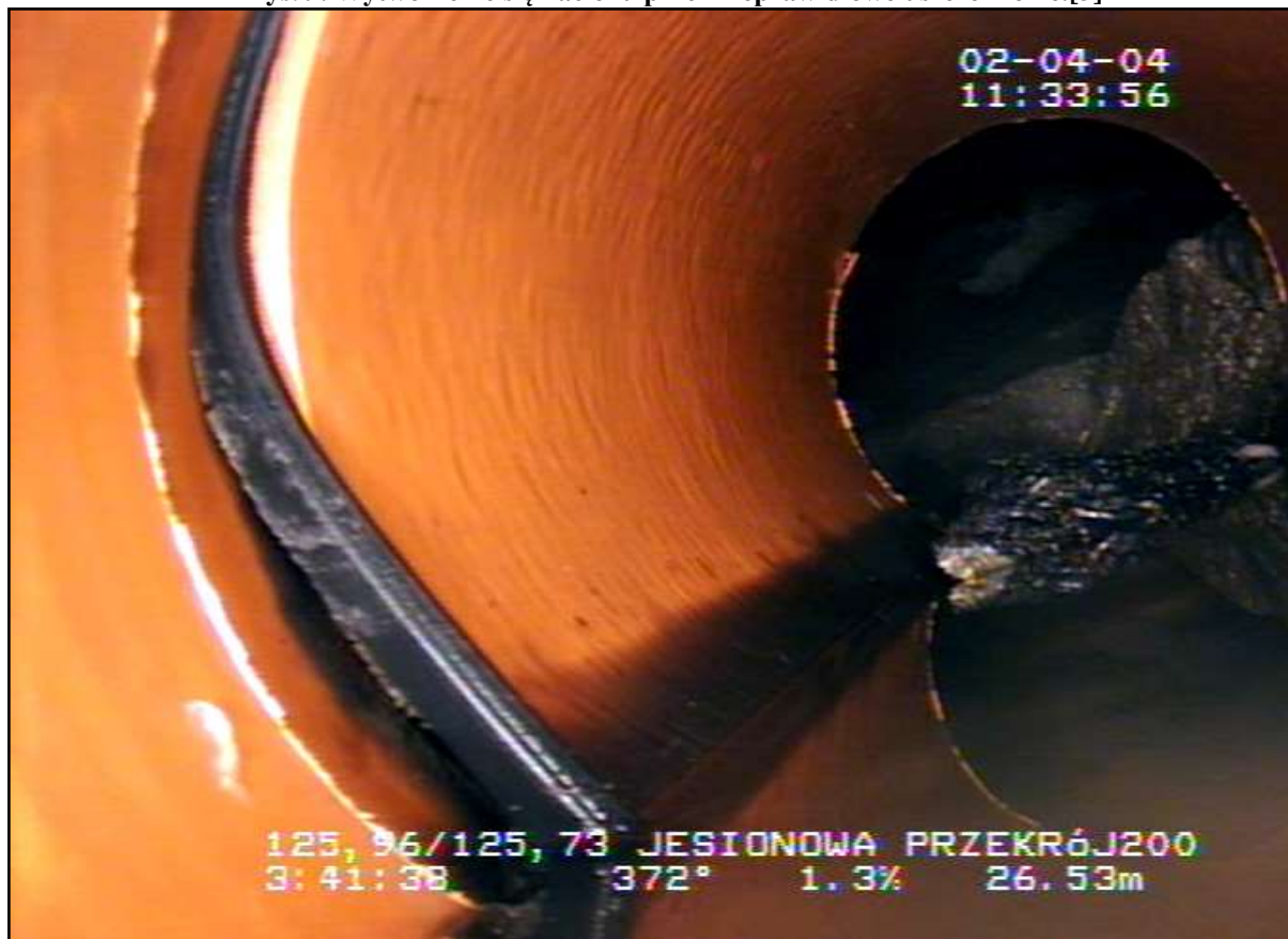
Rys. 10. Nieprawidłowe połączenie rur z PVC.[3]
