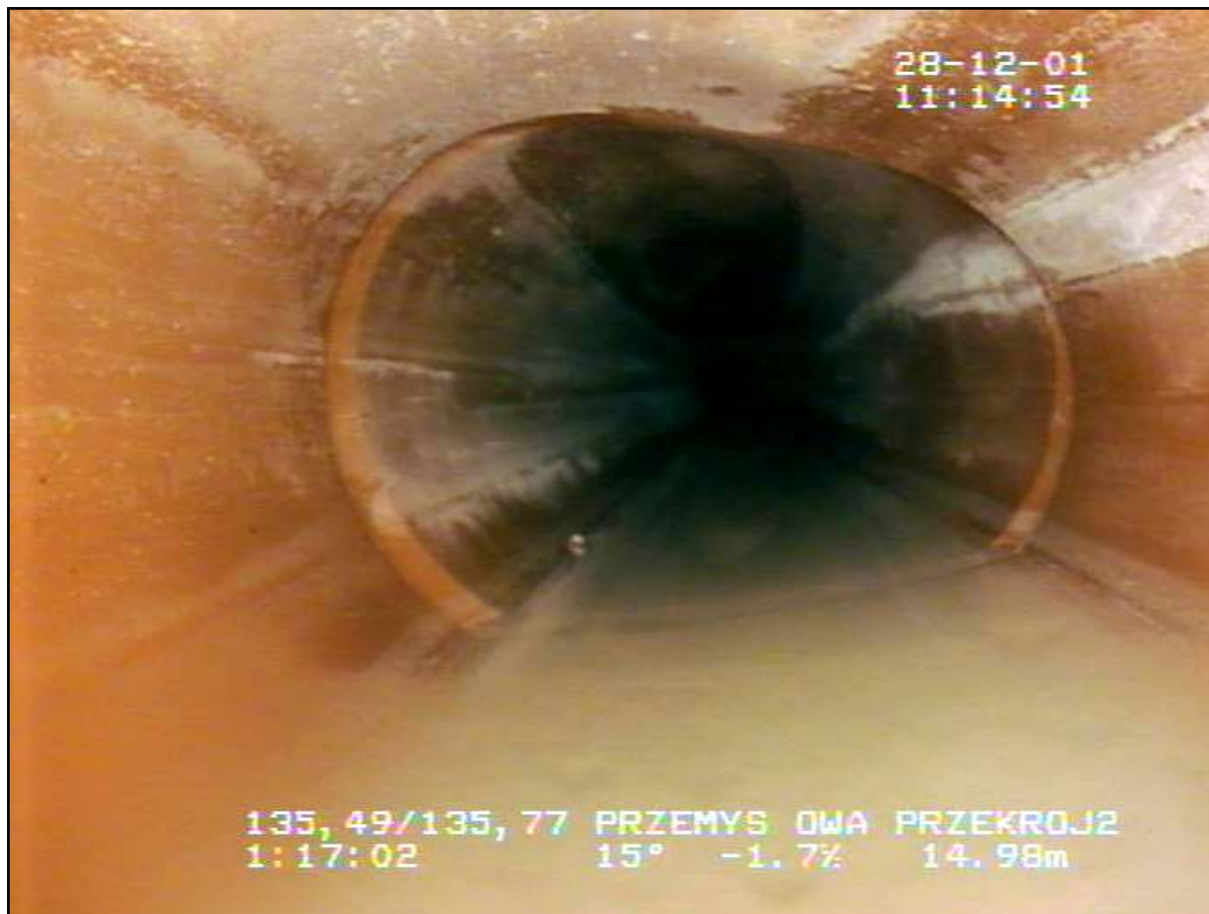
Rys. 8. Zniekształcenie rurociągu PVC przez nadmierne zagęszczenie ziemi nad rurą.[3]
