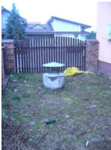
Rysunek 12. Czerpnia GWC żwirowego w Grabówce – miejsce pomiaru temperatury zewnętrznej
