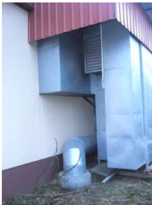
Rysunek 13. Kanał wylotowy GWC żwirowego w Grabówce – miejsce pomiaru temperatury za wymiennikiem
