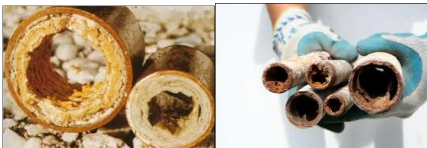
Rysunek 1. Kamień kotłowy osadzający się na przewodach
