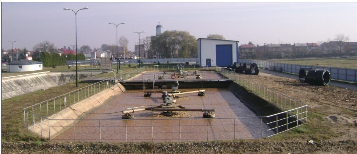
Rysunek 11. Reaktory SBR w zakładowej oczyszczalni ścieków SM Bielmlek
