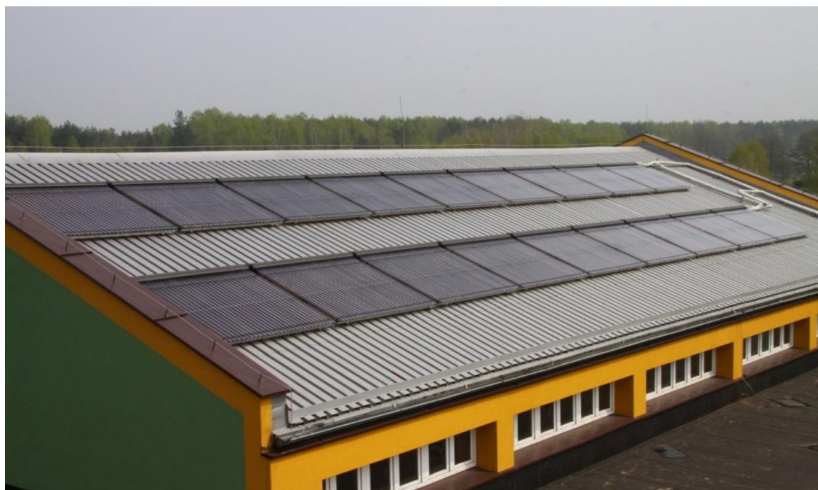
Rysunek 12. Instalacja 18-stu paneli próżniowych kolektorów słonecznych Viessmann Vitosol 200-T w Gminnym Zespole Szkół w Ożimku
