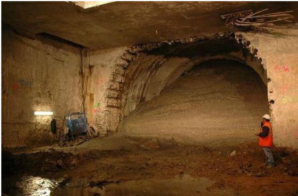
Rysunek 5. Początkowa faza wypływu gruntu po przebicciu stropu wyrobiska
