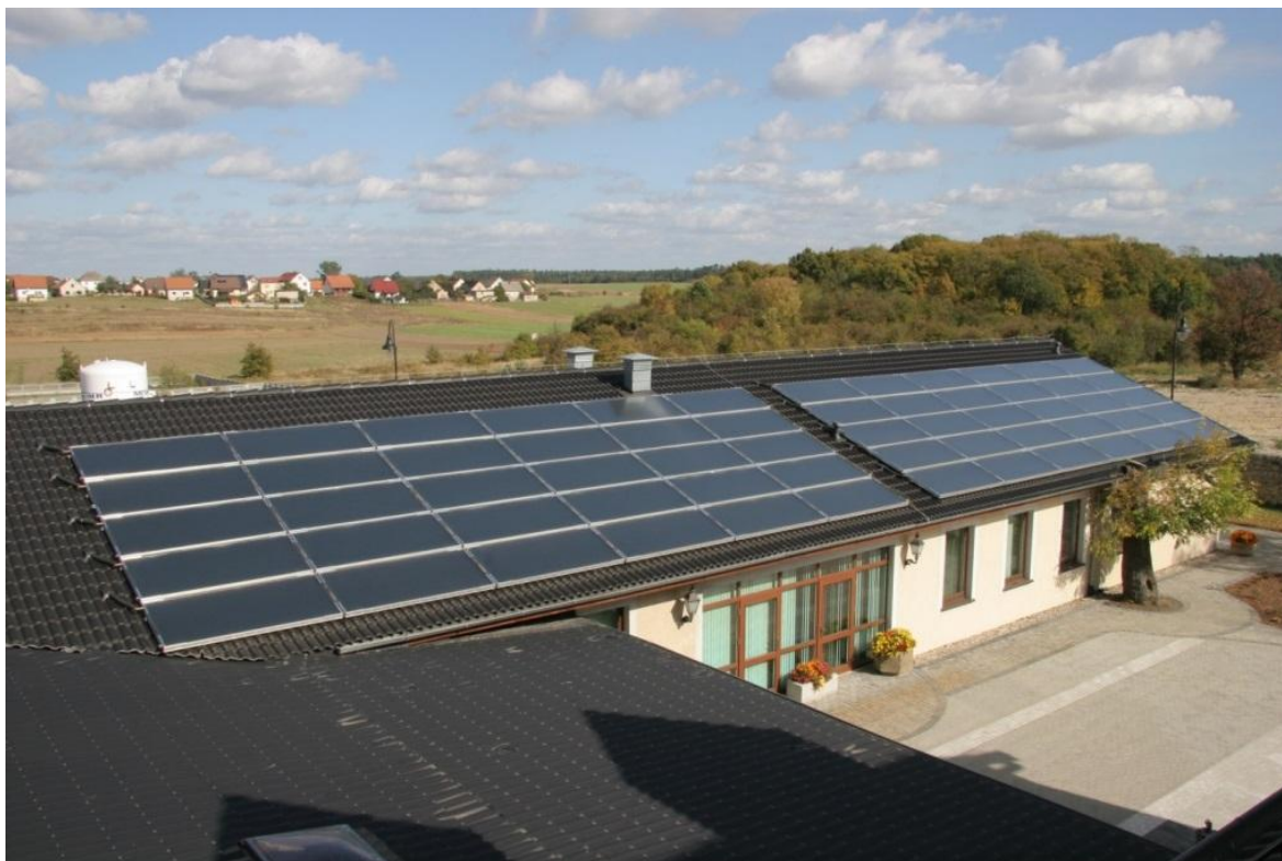
Rysunek 13. Płaskie kolektory słoneczne Vitosol 100-F firmy Viessmann na dachu Ośrodka Rehabilitacyjno-Wypoczynkowy Sebastianum w Kamieniu Śląskim
