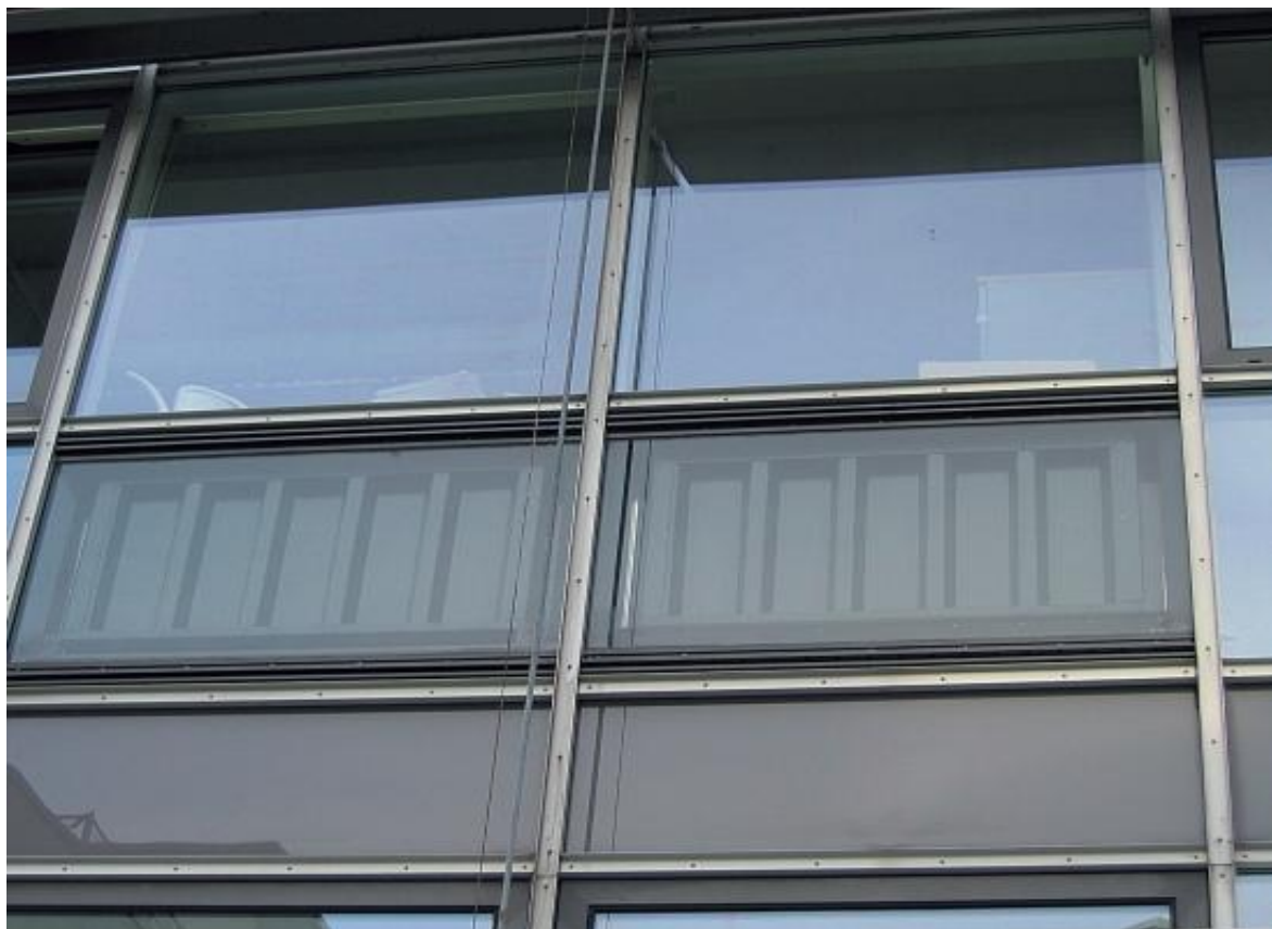
Rysunek 11. Powietrzne kolektory słoneczne zastosowane na biurowcu WAT GmbH w Karlsruhe
