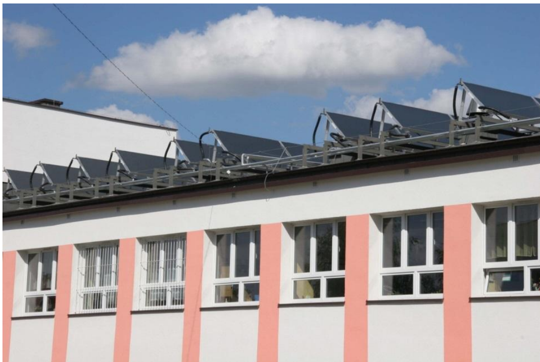
Rysunek 10. Płaskie kolektory słoneczne na dachu Ośrodka Szkolno – Wychowawczego w Lublinie
