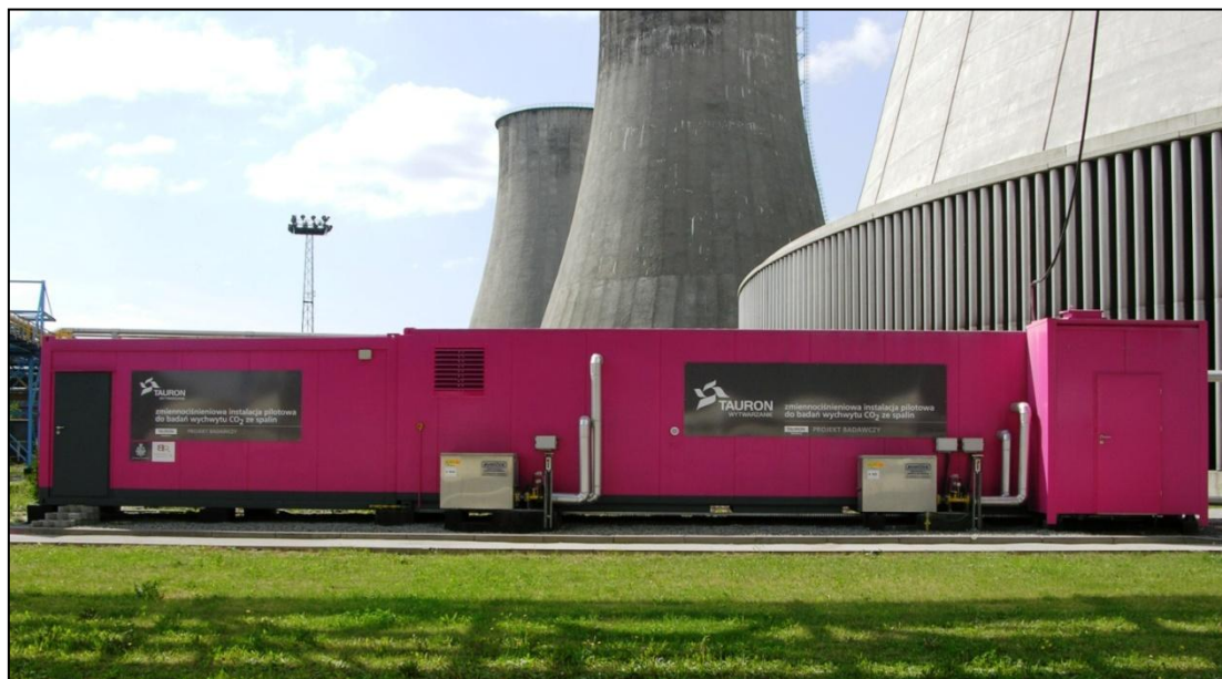
Rysunek 3. Widok instalacji pilotowej DR-VPSSA (strona lewa - kontener nadzoru, strona centralna oraz prawa - kontener technologiczny)
