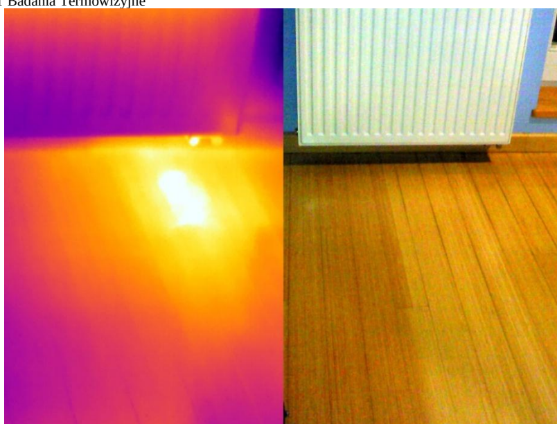
Fot. 4.5. Wyciek wody, zlokalizowany pod parkietem (z lewej: termogram, z prawej stan zastany)
