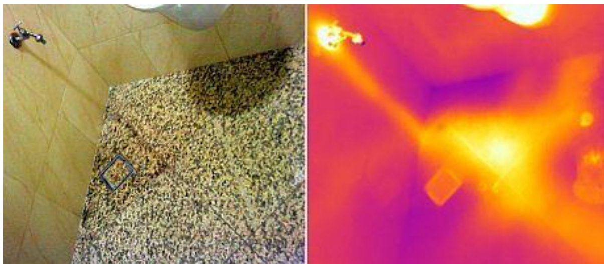
Fot. 4.1. Wyciek wody, zlokalizowany pod glazurą (z lewej: stan zastany, z prawej: termogram)
