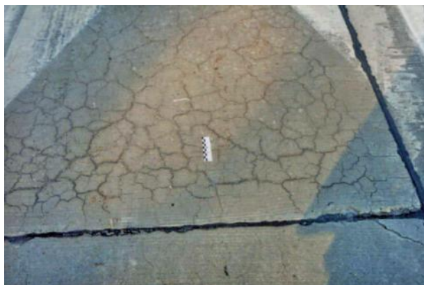
Rysunek 9. Wpływ związków alkalicznych na powierzchnię betonu
